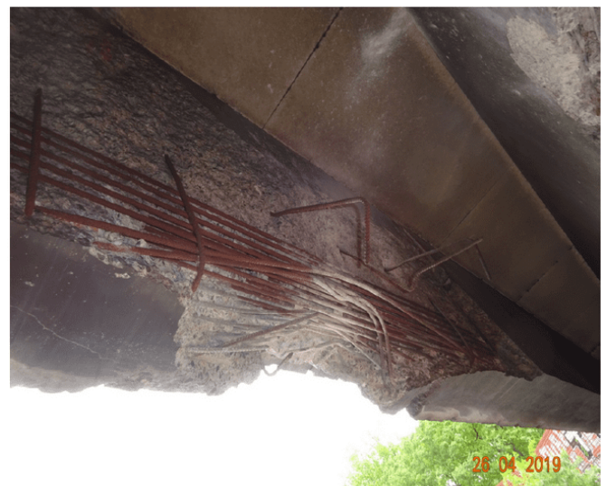
Figure 1 : Désordres suite au choc de 2019
